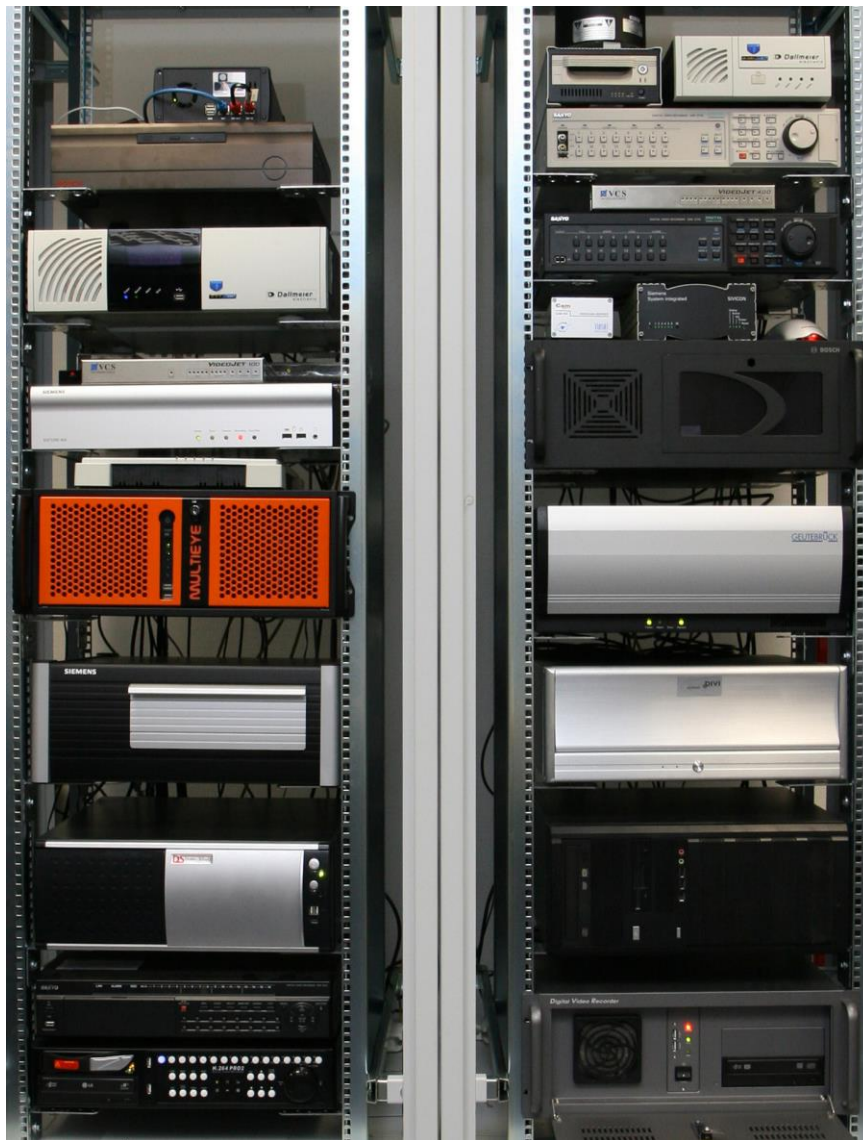
Bild: Typische Geräte, die integriert werden sollen, Accellence Technologies GmbH, Hannover
